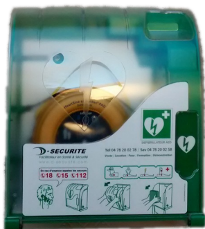
Le défibrillateur installé sur le mur de la mairie
